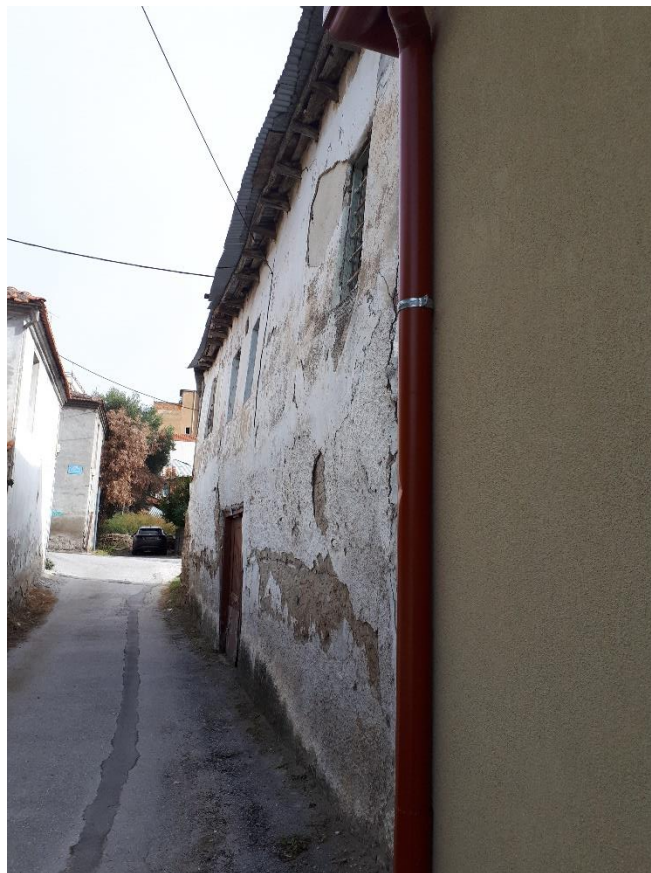
Φωτ. 6 Βέλος κάμψης της βόρειας όψης.
